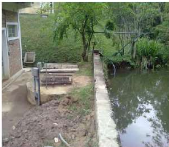
Foto 1 – Antes: Mureta baixa que não evitava transbordamento das águas de chuvas
