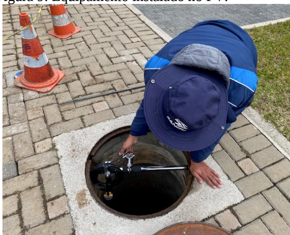
Figura 9: Equipamento instalado no PV.
