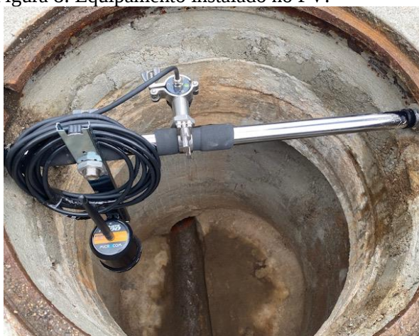
Figura 8: Equipamento instalado no PV.
