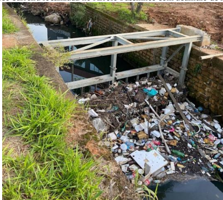
Figura 1 - Eco barreira localizada no Arroio Passinhos com acúmulo de resíduos sólidos.
