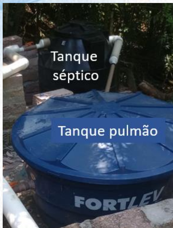
Figura 2: Reator anaeróbico (tanque séptico) e tanque pulmão (para bombeamento).
